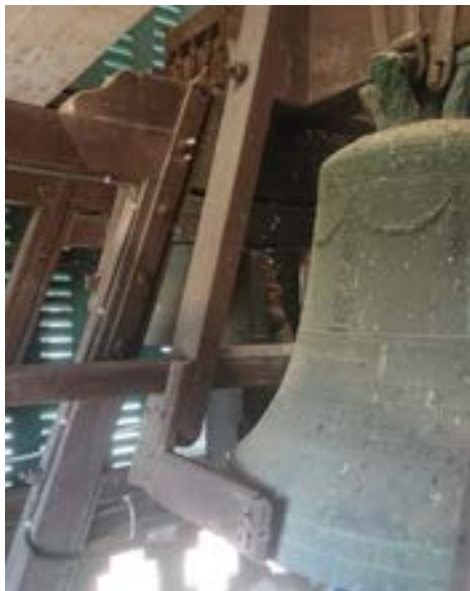
Stato di conservazione dell'impalco e delle campane
